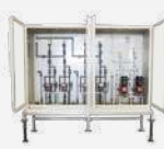
Dosificación en armarios
